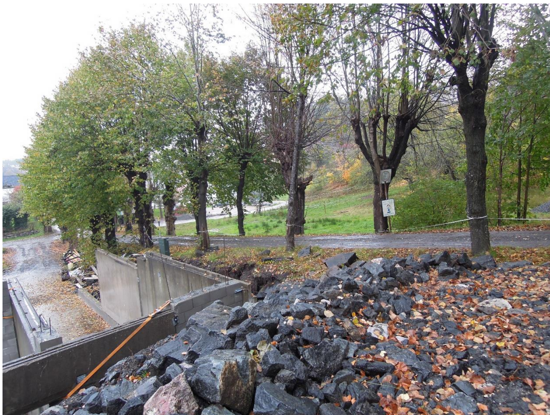
Figur 14. Gravearbeider og plastring med stein på vestsida av alléen kan sannsynligvis ha ført til skader på trerøtter på trær i vestre del av alléen. Det bør følges med på disse trærne kommende år, for å se om det oppstår raske endringer i tilstanden for noen av dem.
